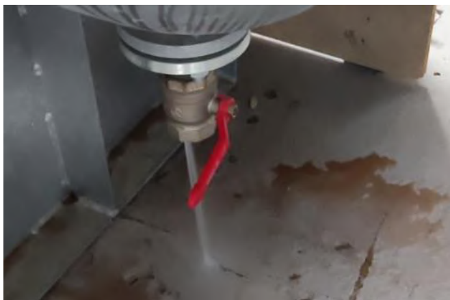
Obraz 9: Woda spuszczone z zaworu dennego w zbiorniku magazynującym. Widoczne są osady, w których mogą rozwijać się bakterie.
