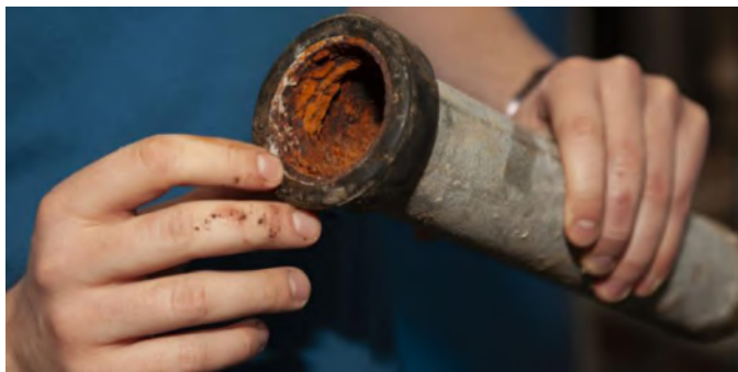
Obraz 13: Fragment przewodu z widocznym osadem mineralnym (kamieniem) wraz z osadem organicznym (biofilmem) oraz produktami korozji. Takie środowisko sprzyja rozwojowi bakterii.
