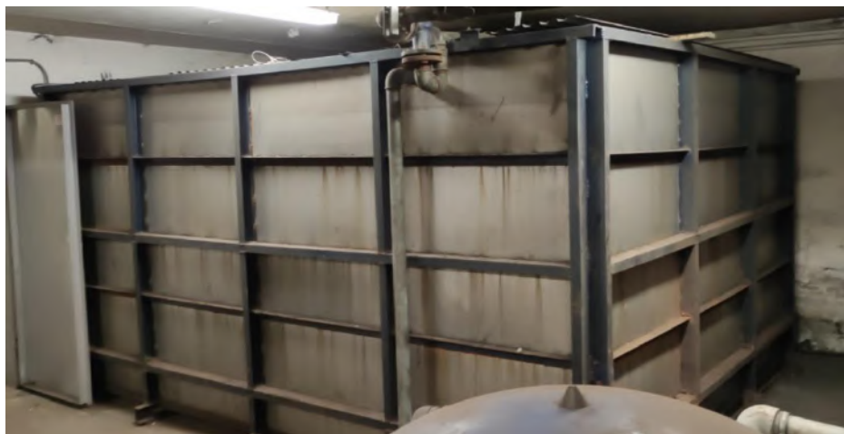
Obraz 6: Przykład zbiornika na wodę zimną, znajdujący się w pomieszczeniu budynku. Zbiornik musi być szczelny, izolowany cieplnie, a ułożenie wlotu i wylotu powinno zapewnić wymianę wody w całej objętości.
