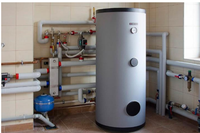
Obraz 7: Zbiornik magazynujący ciepłą wodę użytkową.
